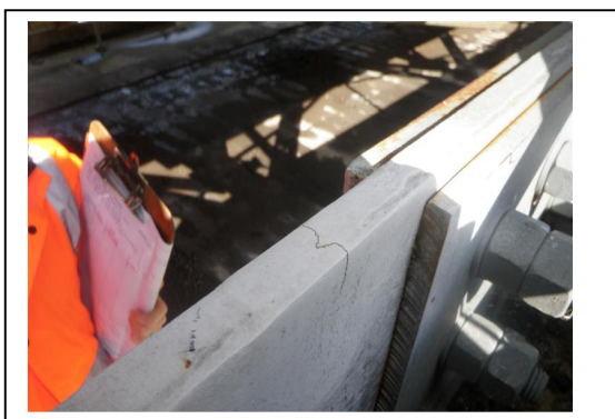
Edge Notch Crack
